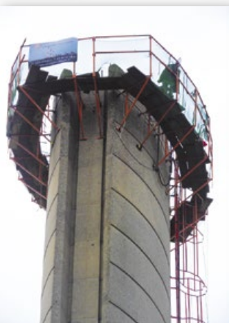
Echafaudage sans emprise au sol
